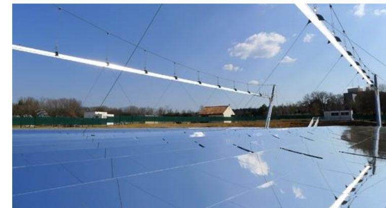
Figure 27 Centrale solaire à capteurs linéaires de Fresnel et caloporteur eau/vapeur
