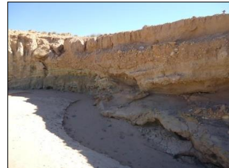
Photo 22 Sapement des berges des oueds Sidi Ayyad et Bou Tazart à l'extérieur du site
