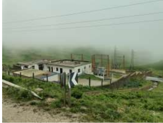
Figure 19-26 : Poste de transfert de l'ONEE existant
